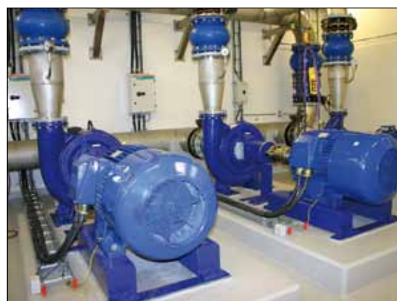
Pumper og rør i trykkøkningsstasjon
