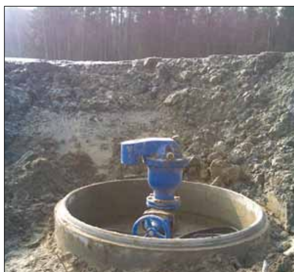
Typisk lufftekum på vannledning
